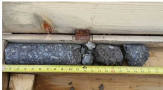
(d) Deficient zone of weak concrete
